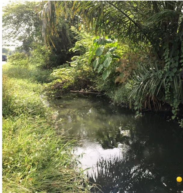
Gambar 5 Dokumentasi Saluran Drainase Sebelum Dibersihkan
