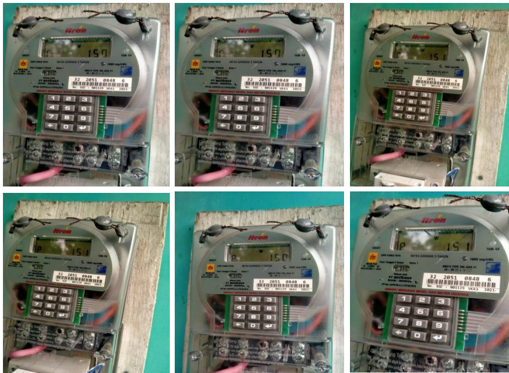
Gambar ;4.14 Daya terpakai pada aerator listrik
