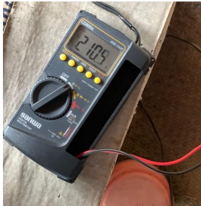
Gambar 4. 7. Pengukuran Tegangan Pada Motor
