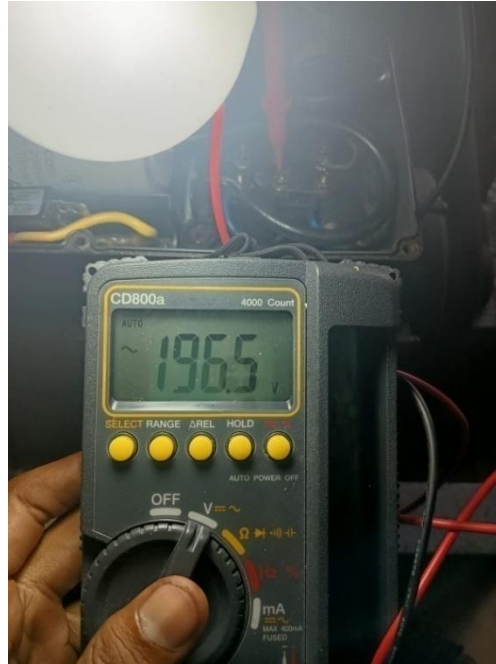
Gambar 4.8 Pengukuran output tegangan tanpa beban
