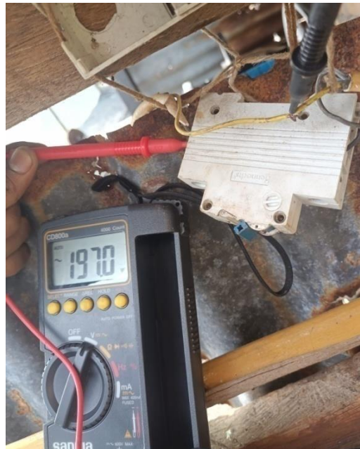
Gambar 4.9 Pengukuran input tegangan berbeban
