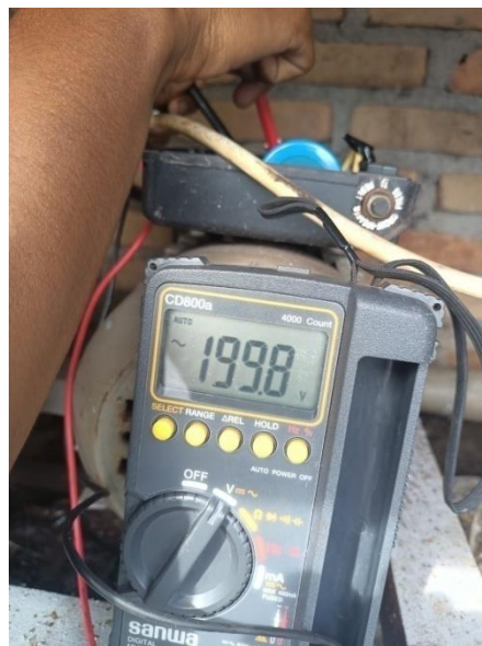
Gambar 4.2 Pengukuran output tegangan tanpa beban
