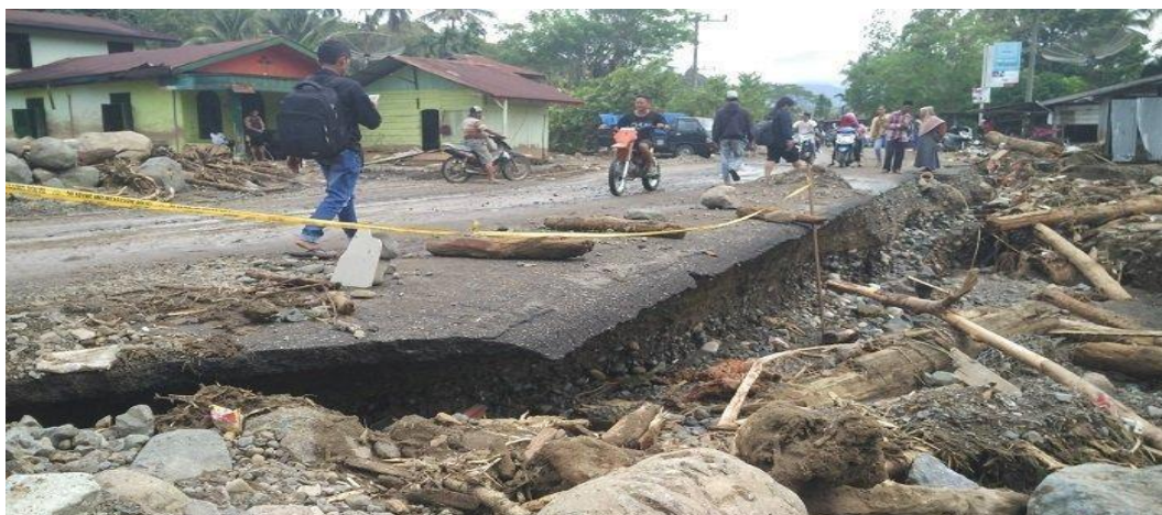
Gambar 4.7: Badan dan bahu jalan yang rusak
