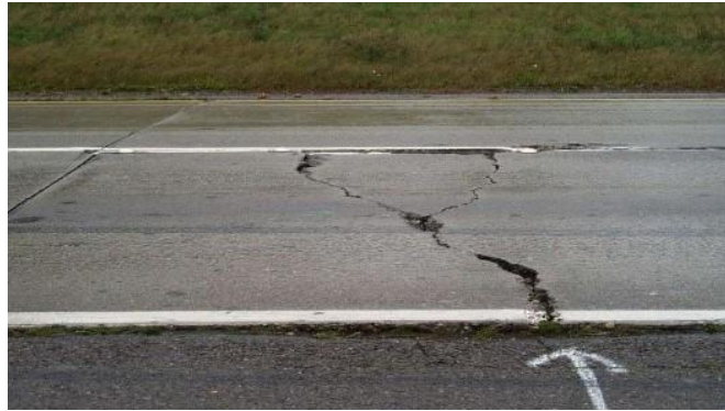
Gambar 2.5: Gambar Retak Sambungan Bahu Perkerasan
