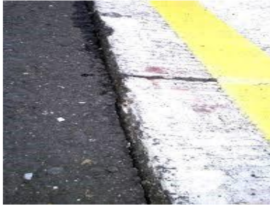
Gambar 2.7: Gambar Retak Sambungan Pelebaran Jalan
