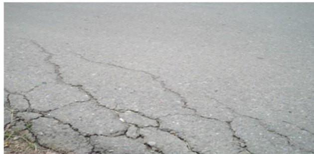
Gambar 2.4: Gambar Retakan Pinggir
