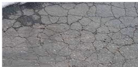
Gambar 2.2: Gambar Retakan Buaya.
