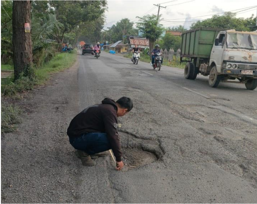
Gambar L.3: Foto Saat pengukuran Luas Kerusakan Lubang.
