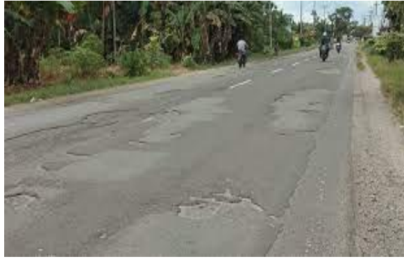
Gambar 2.11: Kerusakan Jalan Terkalupas.
