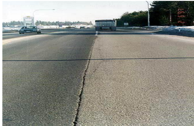
Gambar 2.6: Gambar Retak Sambungan Jalan
