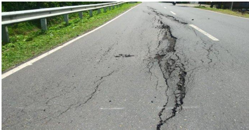
Gambar 2.9: Gambar Kerusakan Amblas
