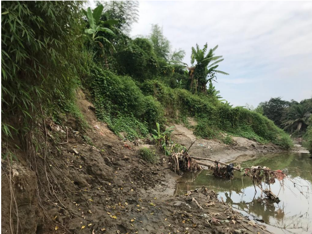
Gambar L. 1: Lokasi Longsor pada Marking 095.
