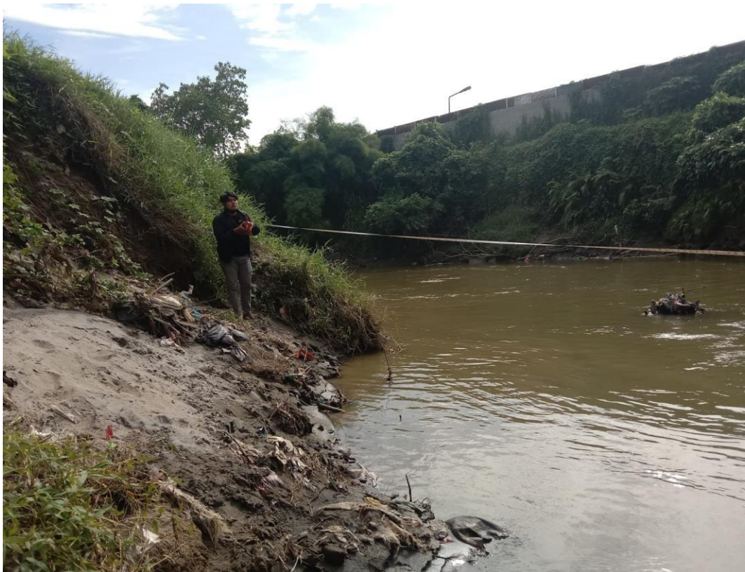
Gambar L. 4: Mengukur Panjang Longsor.
