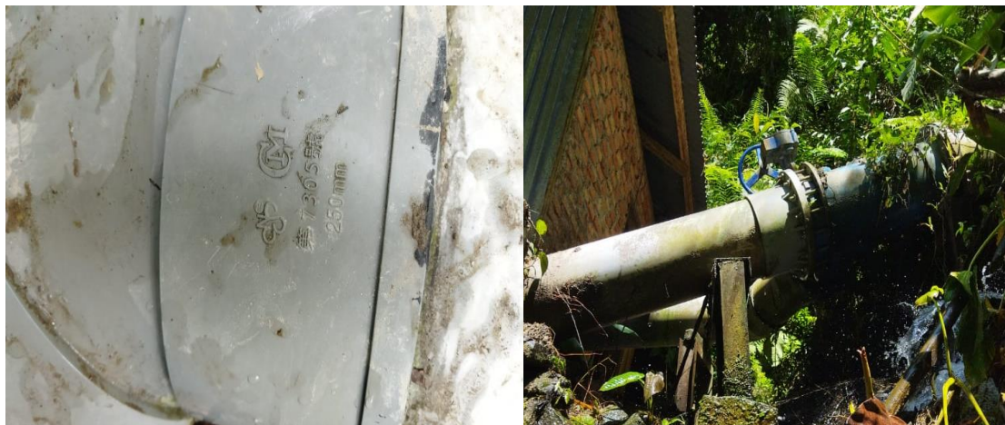
Gambar 4. 4 Pipa Pesat PLTMH Bintang Asih
