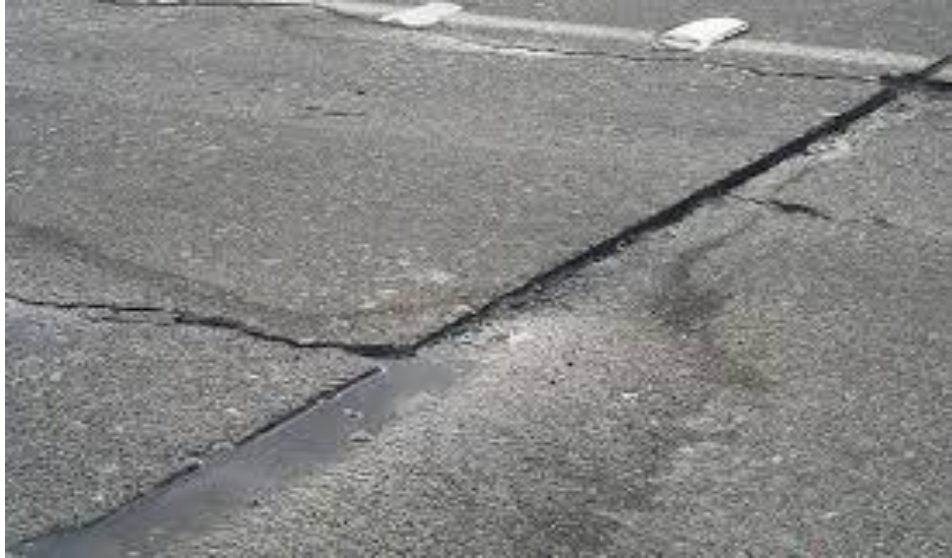
Gambar 2.6: Retak Sambungan Pelebaran.
