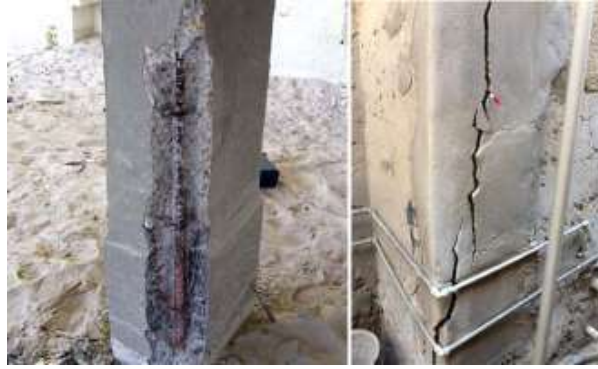
Gambar 1.1: Beton yang terkorosi.
