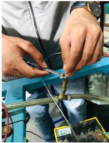
Gambar 4. 11. Pemasangan Sensor Menuju Radiator
