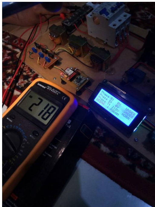
Gambar 4.16 Pengukuran Fasa T PLN
