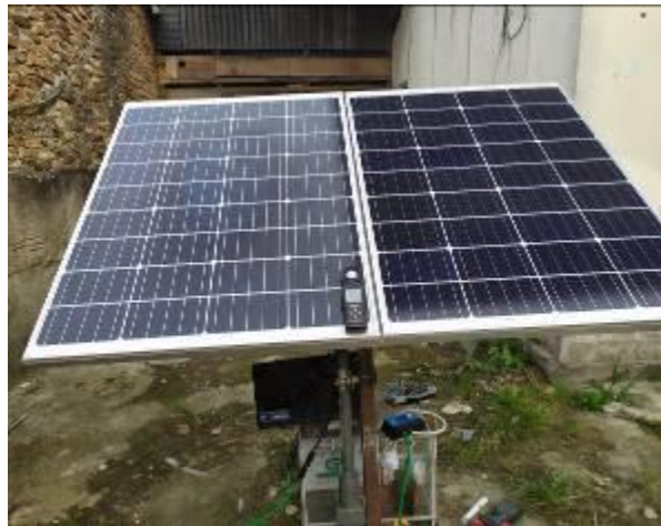
Gambar 4.3 pengujian panel surya
