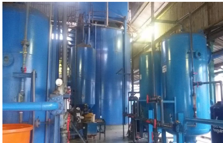
Gambar 2.31 Fasilitas Pada Stasiun Demin Plant
