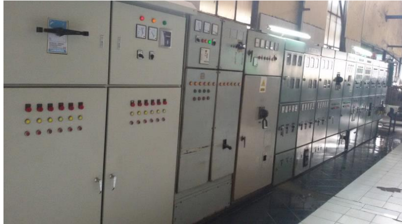
Gambar 2.29 Panel Kontrol Utama Pada Kamar Mesin
