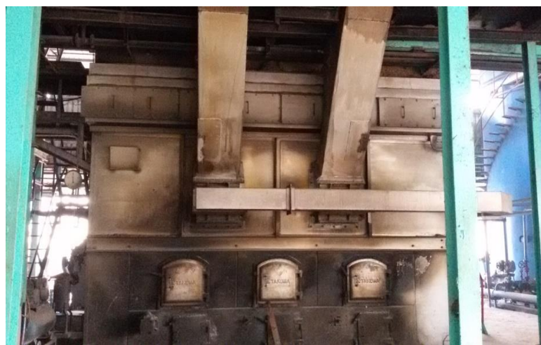
Gambar 2.26 Ruang Bahan Bakar Boiler Pada Stasiun Ketel Uap
