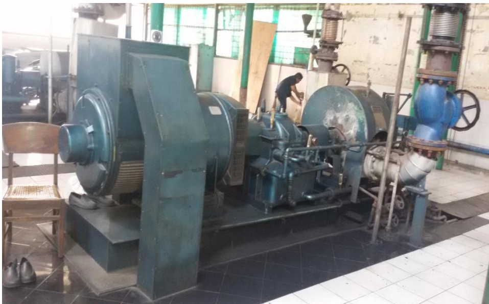
Turbin Uap No. 3 Kapasitas 850 kVA
