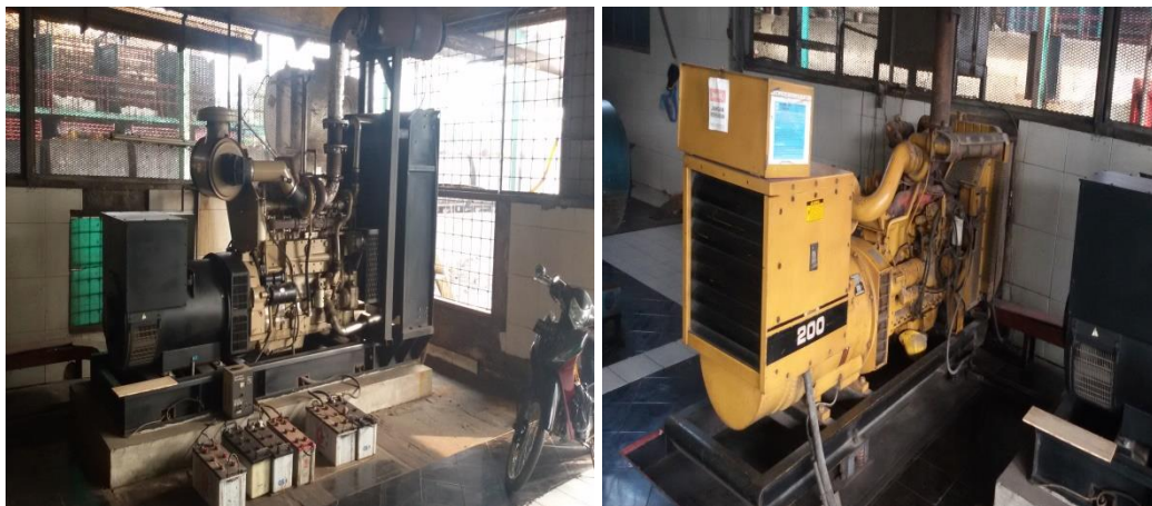
Gambar 2.28 Genset ( Disel-Generator ) Berkapasitas 500 KVA dan 250 KVA
