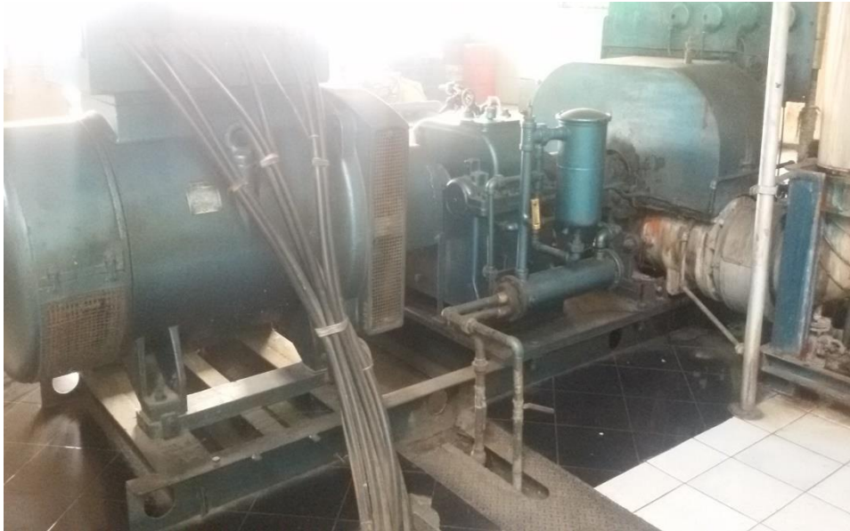
Turbin Uap No. 1 Kapasitas 750 kVA
