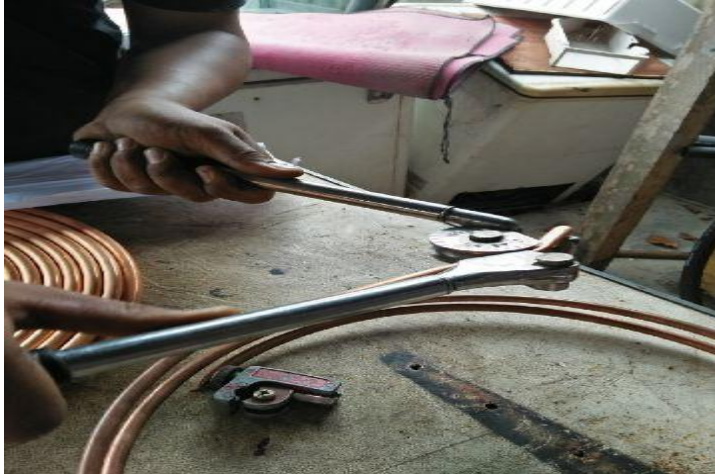
Gambar 4.2 pembengkokkan pada pipa tembaga pada evaporator
