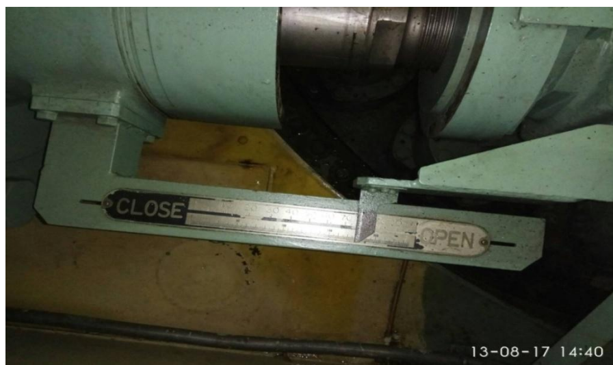
Gambar 3.1 Guide vane Meter (sumber; Foto survei lapangan PLTA Siguragura)
