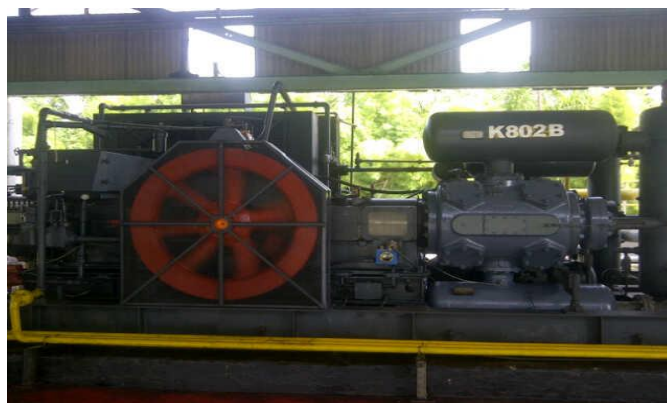
Gambar 2.5. Kompresor DPC 360 K-802-B
