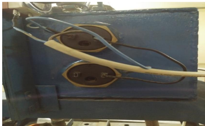
Gambar 3.7 Tangki Pemanas Dan Heater
