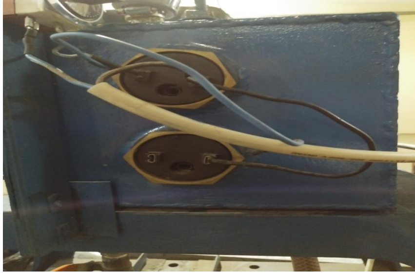
Gambar 3.9 Tangki Pemanas Dan Heater
