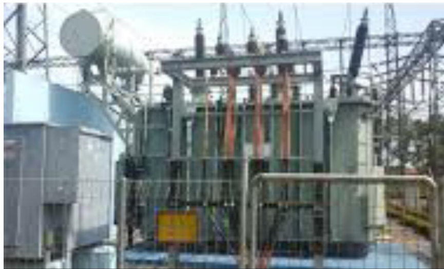
Gambar 2.7 Transformator daya Gardu Induk Glugur
