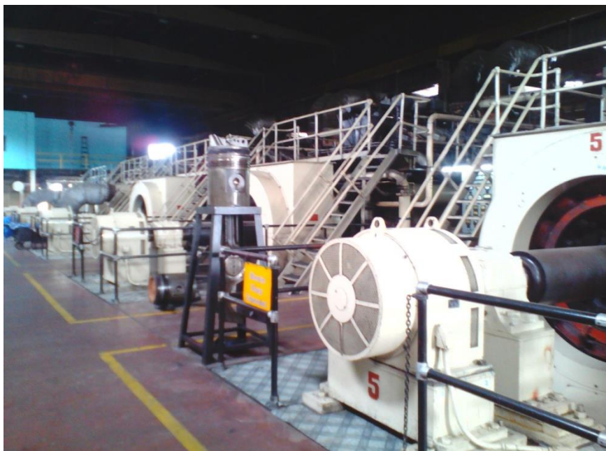
GAMBAR GENERATOR PEMBANGKIT LISTRIK TENAGA DIESEL TITI KUNING
