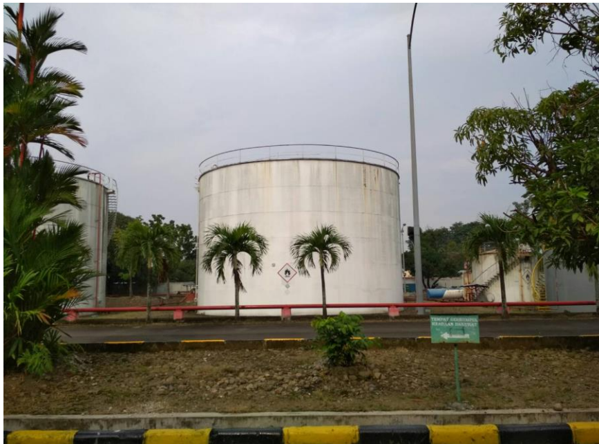
GAMBAR TANGKI BAHAN BAKAR PEMBANGKIT LISTRIK TENAGA DIESEL TITI KUNING.
