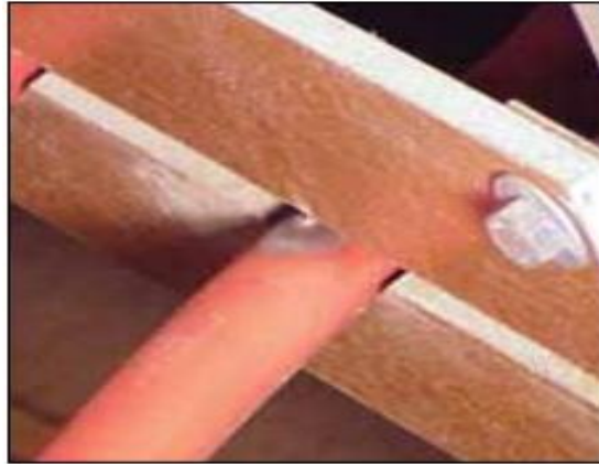
Gambar 2.11 : kabel jumper mediumvoltage tidak terlindungi
