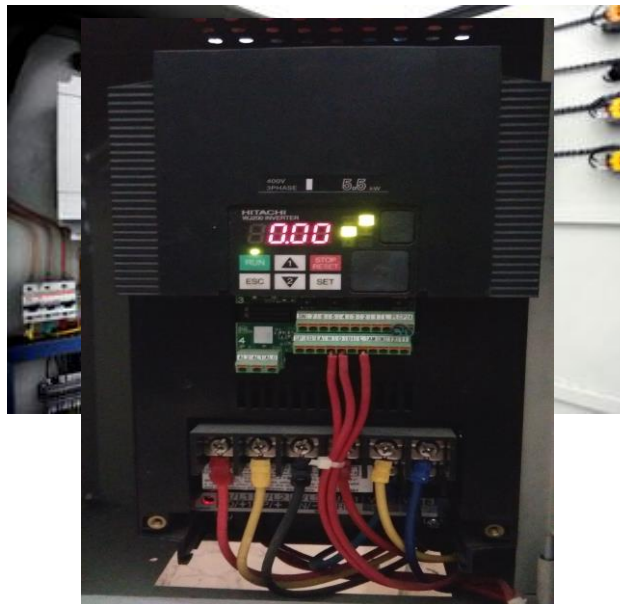
Gambar 2.3 Panel Utama Inverter (VFD)
