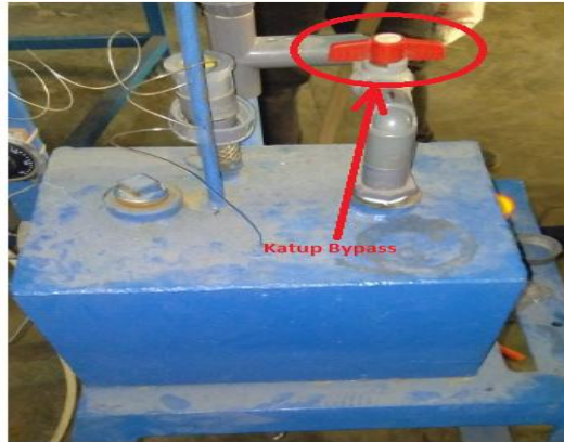
Gambar 3.20 Bukaan Katup Bypass
