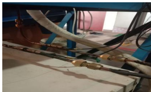
Gambar 4.31. Pipa Masuk Kondensor
