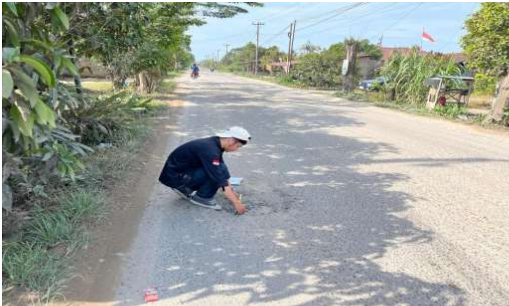
Gambar 4 Menghitung Kerusakan Jalan Jenis Lubang
