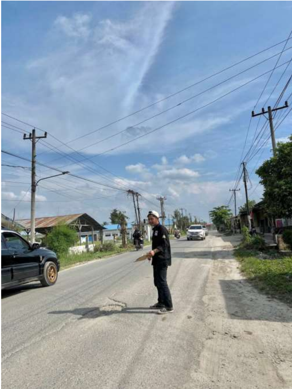
Gambar 1 Menghitung Kerusakan Jalan Jenis Pelapukan Dan Pelepasan Butiran
