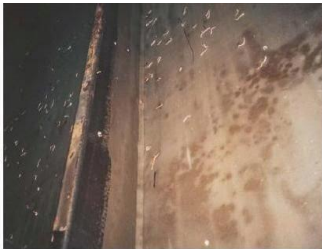
Gambar 2. 6 Korosi Celah (Hasyim et al., 2017)
