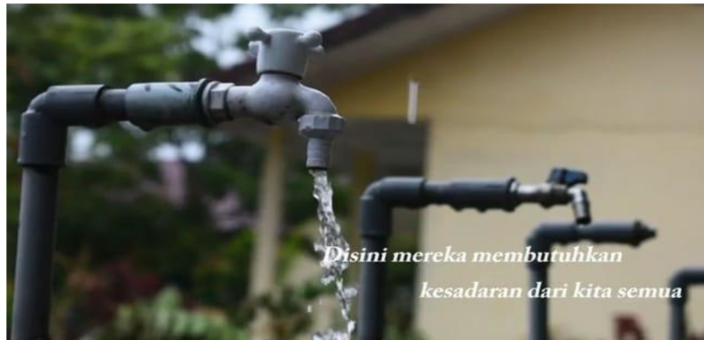
Gambar 4. 4 keran air diluar ruangan yang dibiarkan terbuka dan mengalir
