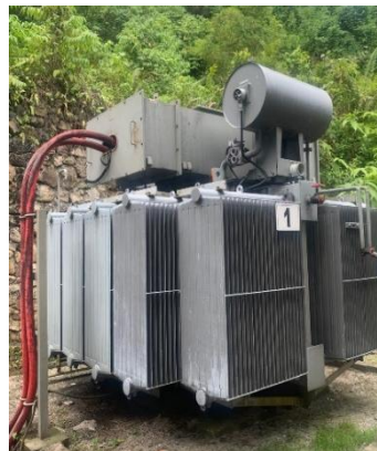
Gambar 2. 11 Transformator Step Up PLTM Karai 7 (Dokumen Pribadi)
