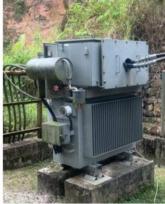
Gambar 2. 12 Transformator Auxiliary PLTM Karai 7 (Dokumen Pribadi)
