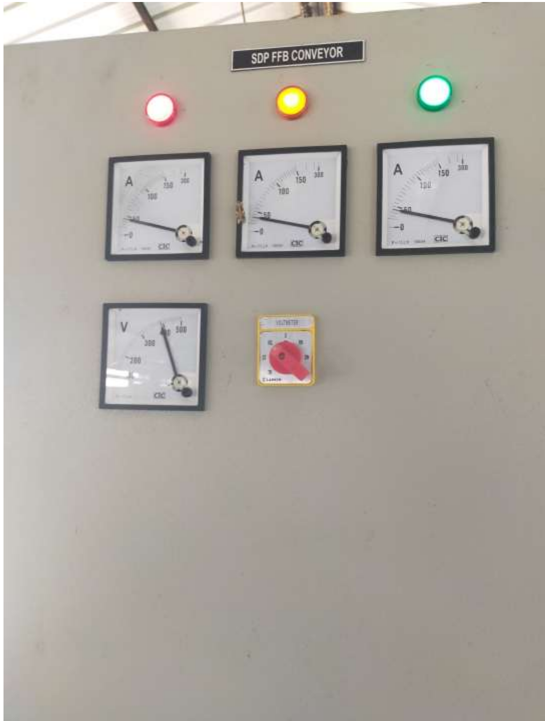
Lampiran 4. Panel kontrol (Tegangan dan Arus R,S dan T)
