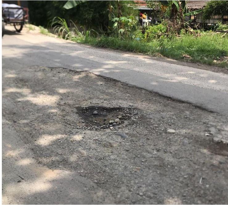
Gambar L.7: Kerusakan di turunan jembatan yang ada di Jl. Paya Bakung-Tandem
