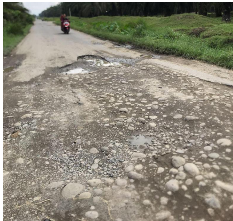
Gambar L.6: Kerusakan di Jl. Paya Bakung-Tandem
