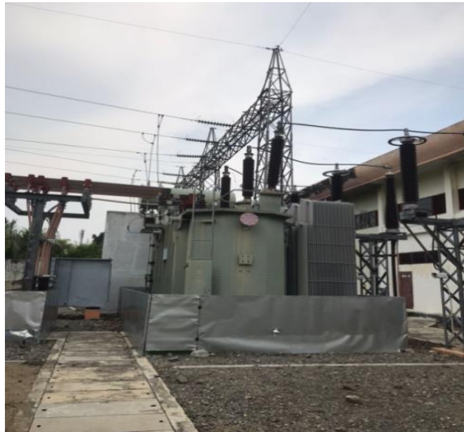
Gambar 2. 14 Trafo Daya di GI PLN GLUGUR
