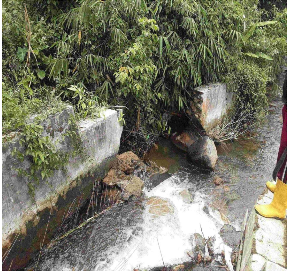
Gambar L. 2 Kerusakan pada tanggul saluran primer
