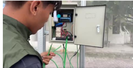
Gambar 4.8 instalasi catu daya menggunakan panel surya
