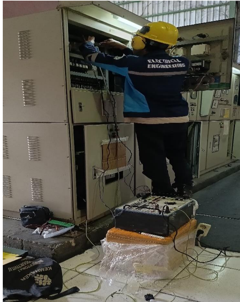
Gambar 4.7. Pengujian rangkaian sinkron pada panel genset
