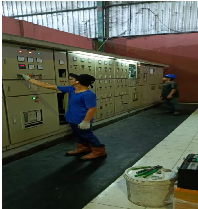
Gambar 4.11. Sinkronisasi Kembali antara panel genset dan turbine
