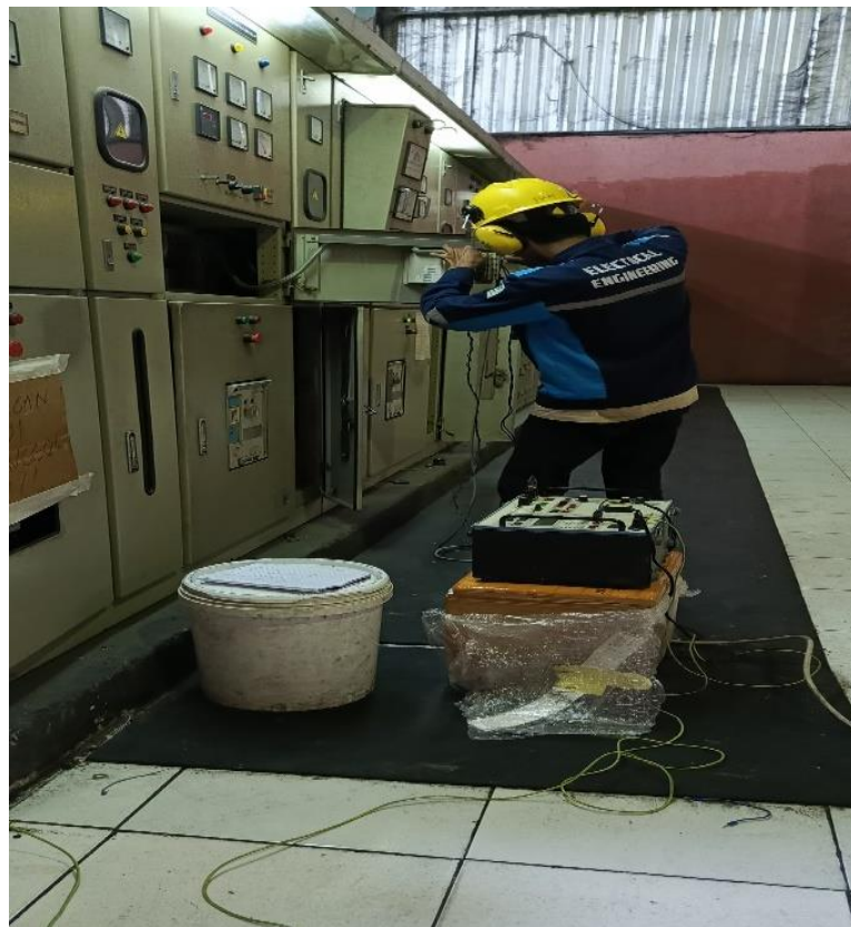
Gambar 4.9. Pergantian proteksi EFR yang mengalami kerusakan
