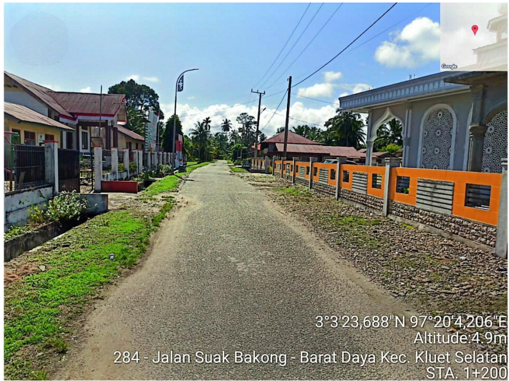
Gambar L.25: Kondisi jalan di STA 1+200.
