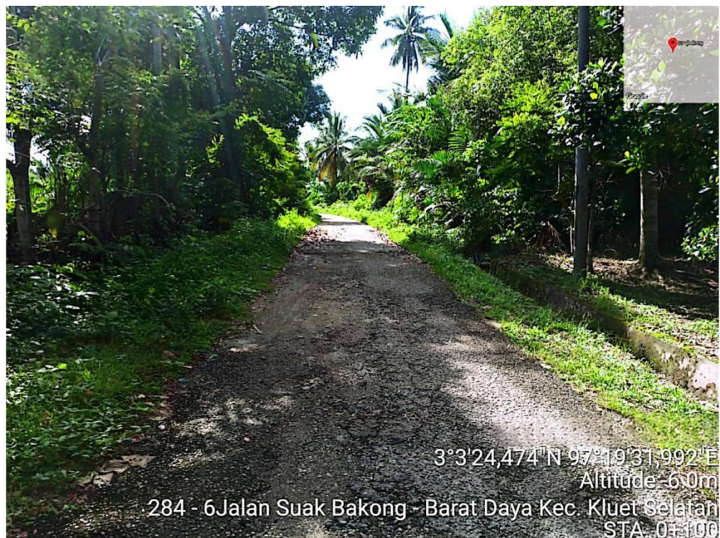
Gambar L.4: Kondisi jalan di STA 0+100.
