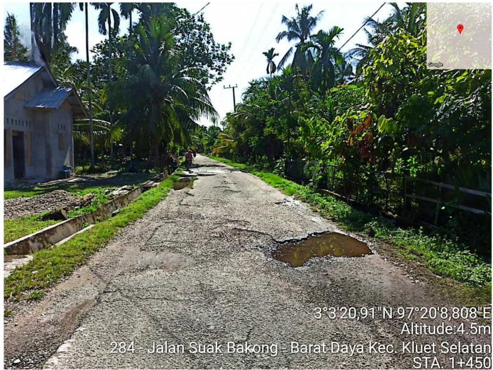
Gambar L.29: Kondisi jalan di STA 1+450.
