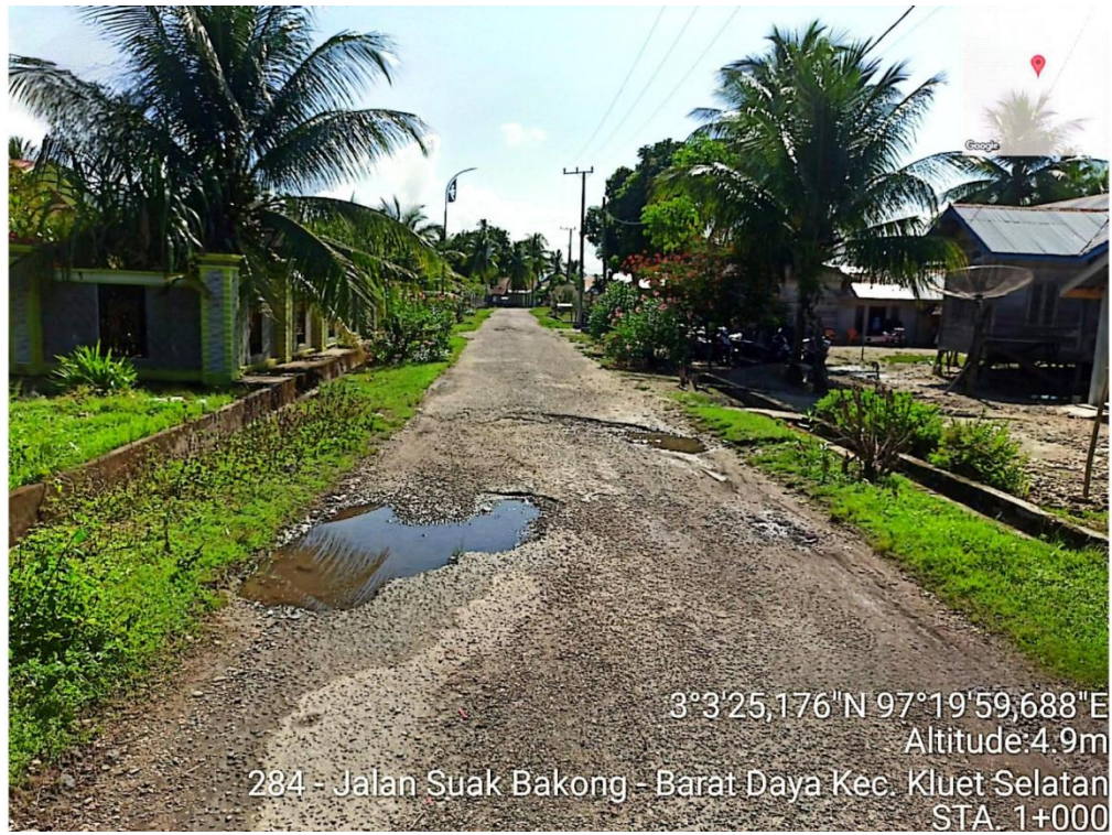
Gambar L.23: Kondisi jalan di STA 1+000.
