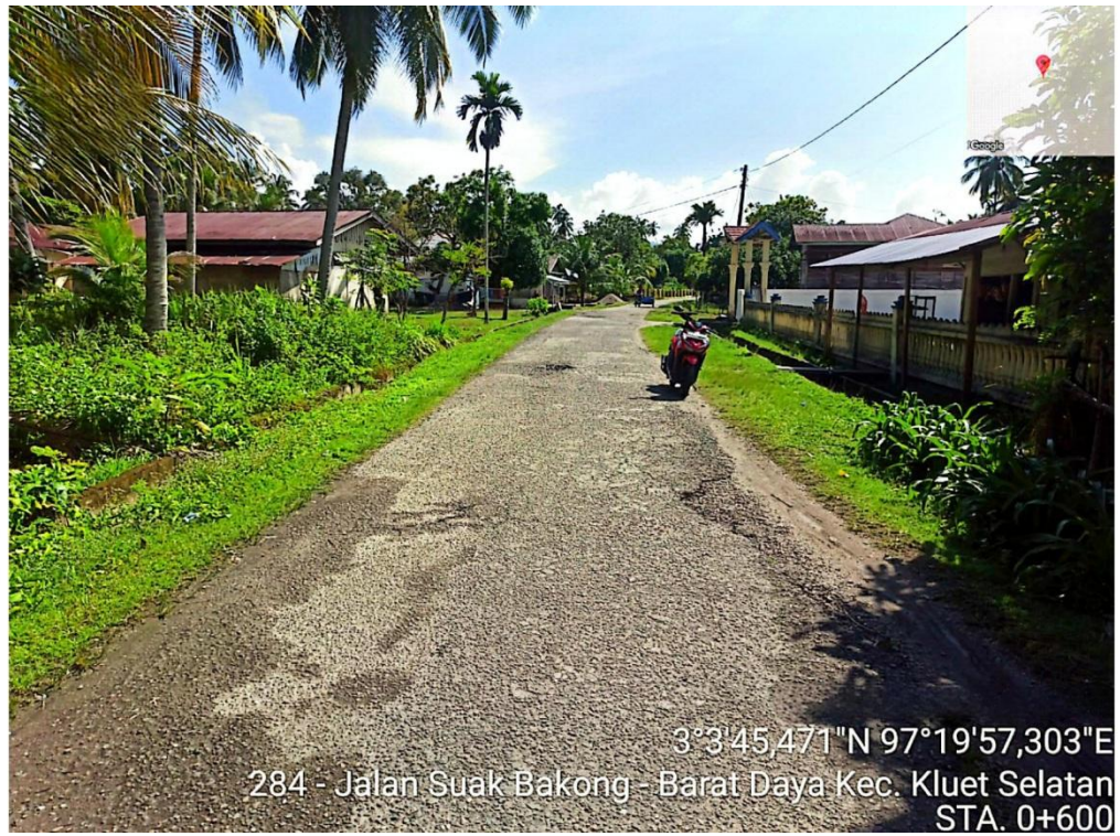
Gambar L.13: Kondisi jalan di STA 0+600.
