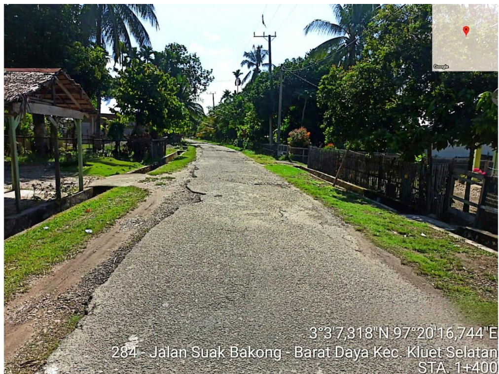
Gambar L.28: Kondisi jalan di STA 1+400.
