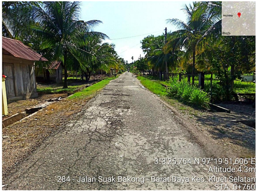
Gambar L.17: Kondisi jalan di STA 0+760.
