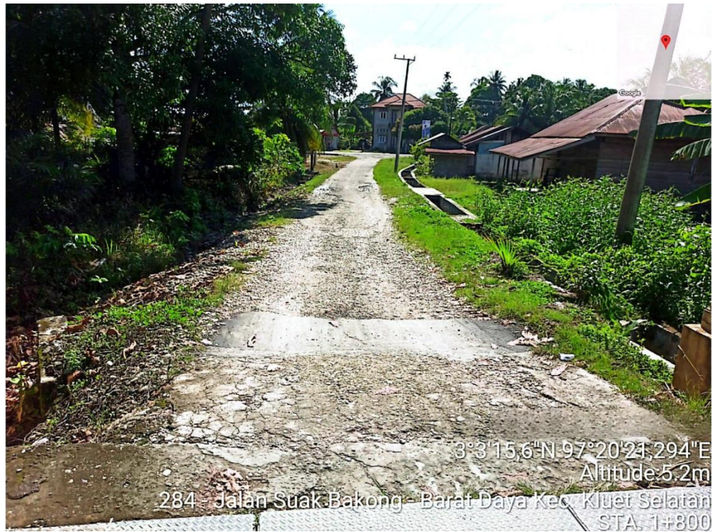
Gambar L.35: Kondisi jalan di STA 1+800.
