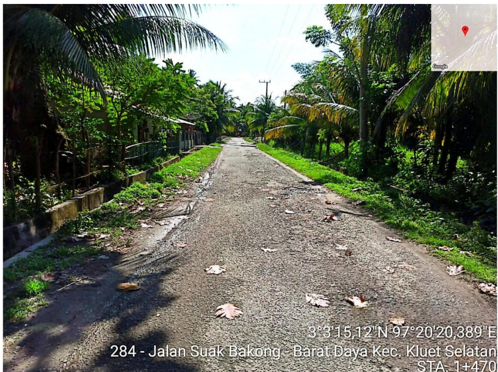
Gambar L.30: Kondisi jalan di STA 1+470.
