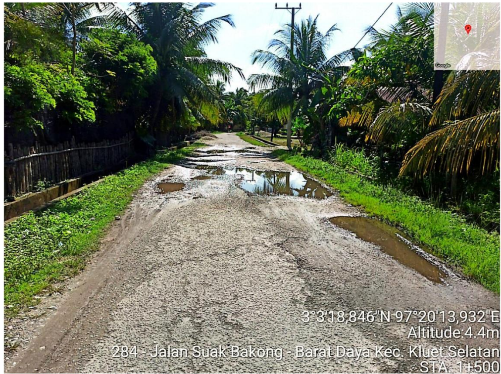
Gambar L.31: Kondisi jalan di STA 1+500.
