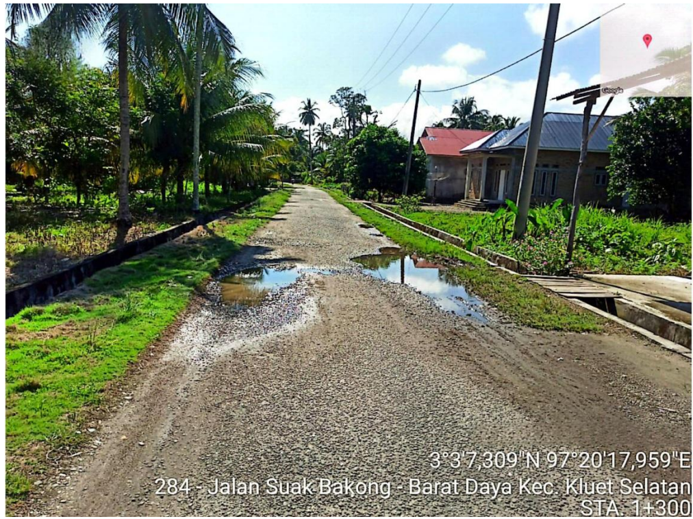
Gambar L.27: Kondisi jalan di STA 1+300.
