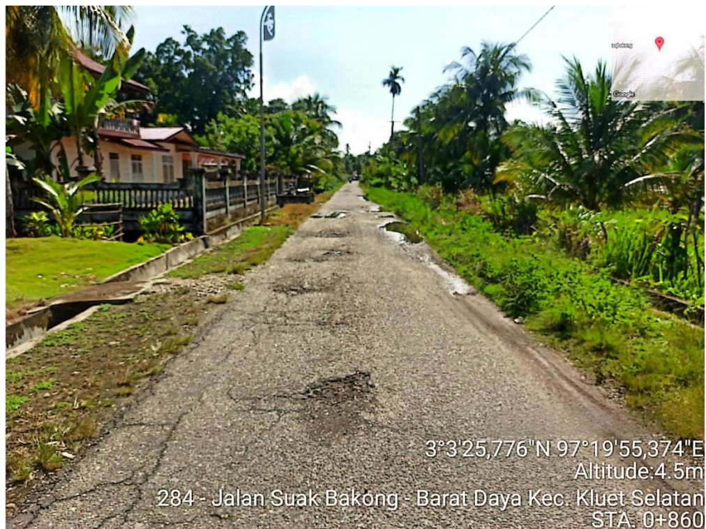
Gambar L.20: Kondisi jalan di STA 0+860.
