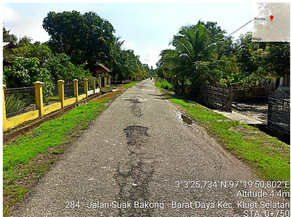
Gambar L.16: Kondisi jalan di STA 0+750.
