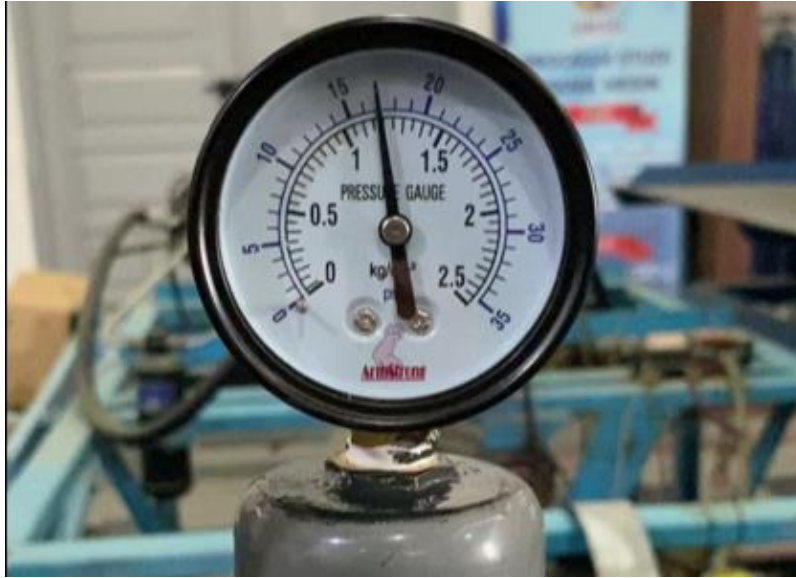
Pengukuran tekanan discharge
