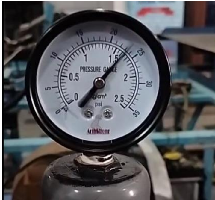
Pengukuran tekanan discharge
