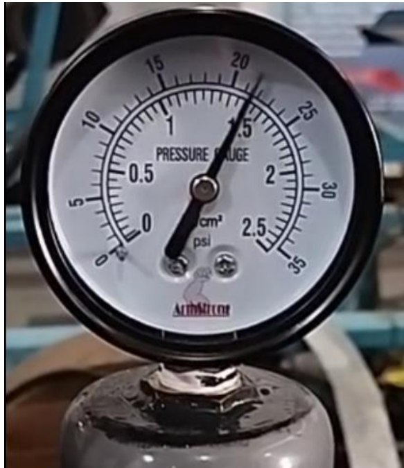
Pengukuran tekanan discharge
