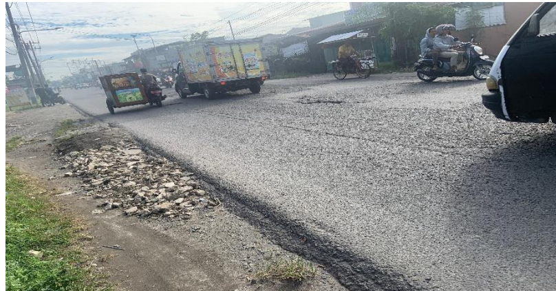
Gambar 3. 6: Retak Memanjang (Hasil survey dilapangan)
