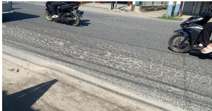
Gambar 3. 10: Retak Tepi (Hasil Survey dilapangan)
