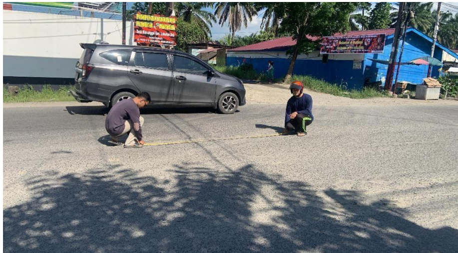
Gambar L.2 : Foto Pengambilan Data Kerusakan
