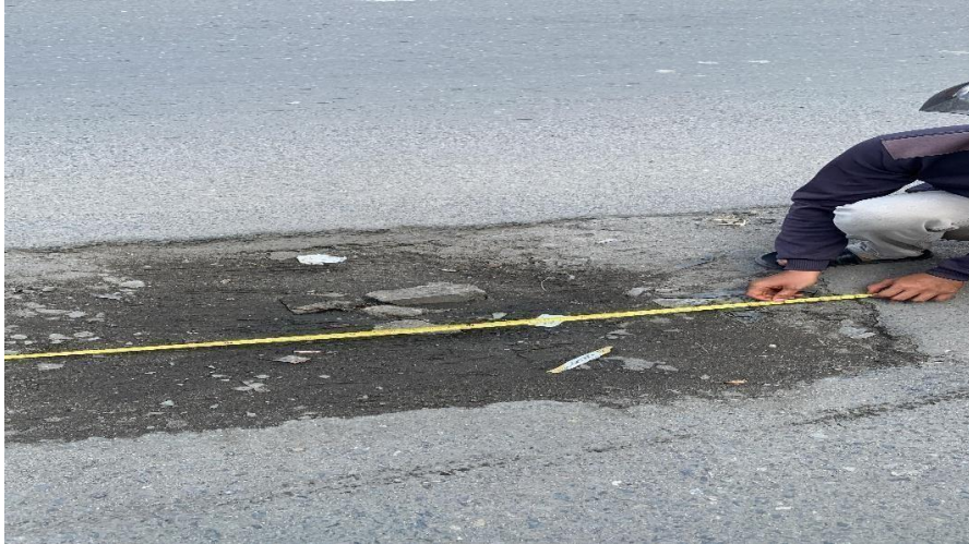
Gambar L.4 : Foto Pengambilan Data Kerusaka
