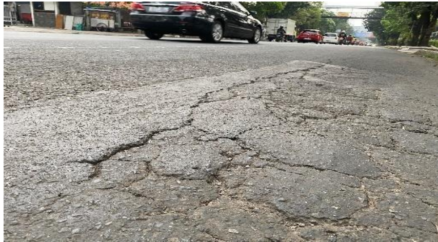
Gambar 2. 11: Penurunan lajur/bahu (Zuhdi et al., 2024)
