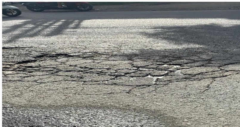
Gambar 3. 4: Retak Kulit Buaya (Hasil Survey dilapangan)
