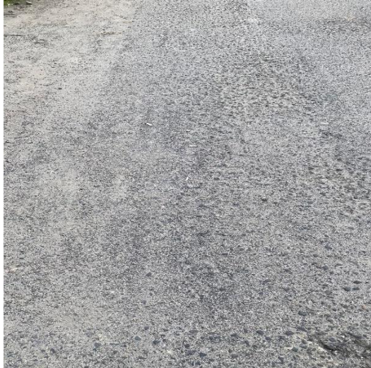
Gambar 4. 4 :Kerusakan Jenis Butiran Lepas
