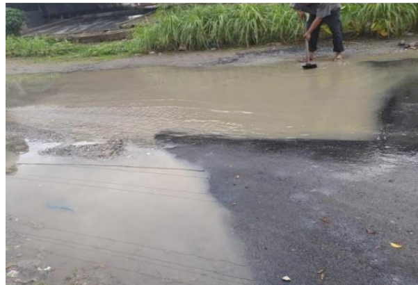
Gambar 4. 3 : Genangan air di Jalan Bunga Teratai
