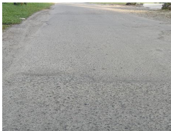
Gambar 4. 8 : Kerusakan Jenis Retak Pinggir
