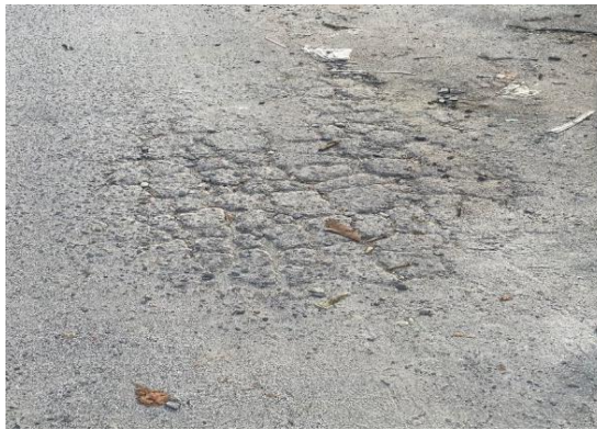
Gambar 4. 7 : Kerusakan Jenis Retak Pinggir (Edge Cracks)
