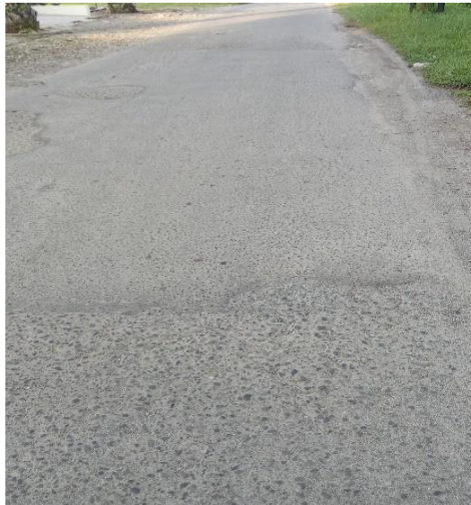
Gambar 4. 5 : Kerusakan Jenis Butiran Lepas
