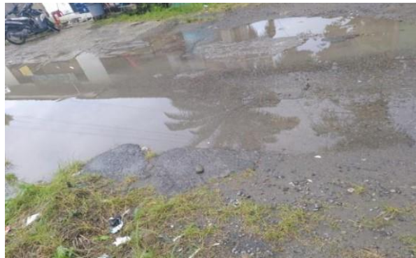
Gambar 4. 2 : Genangan air di Jalan Bunga Teratai
